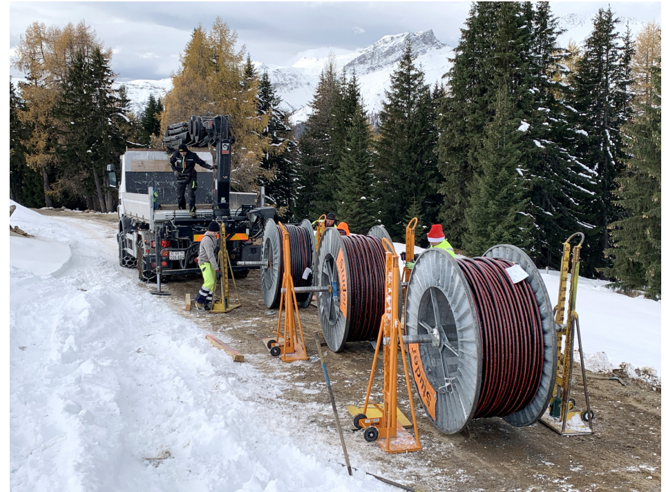
Mittelspannungssanierung Usser Isch – Clavadeler Alp
