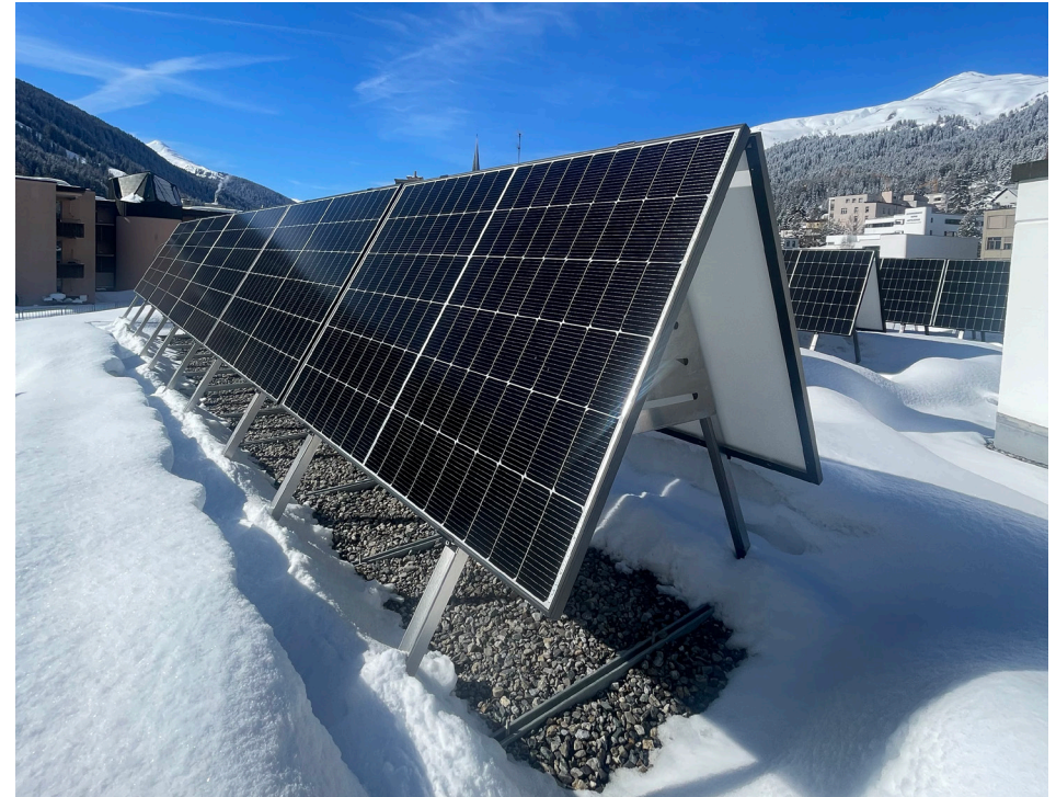
PV Anlage – auf dem Gebäude der EWD AG, Talstrasse 35
