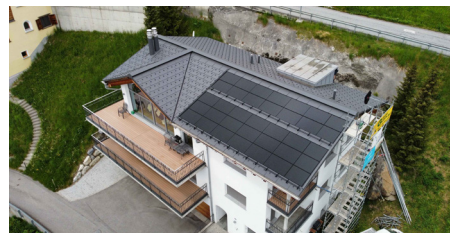
Davos Platz, Indachanlage mit Batteriespeicher
