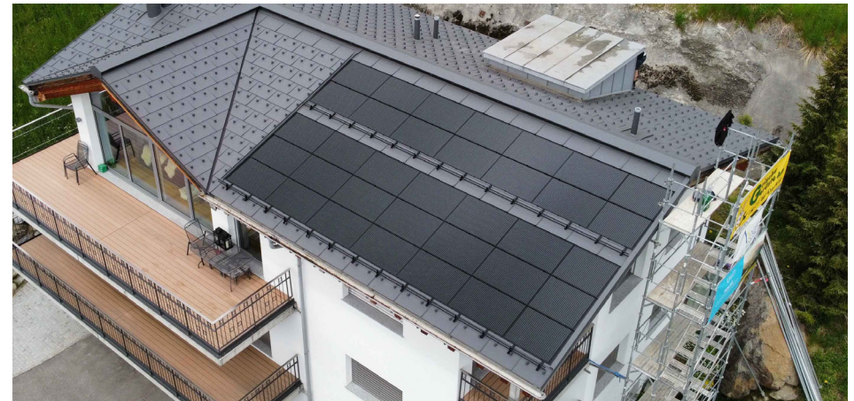
Davos Platz, Indachanlage mit Batteriespeicher
