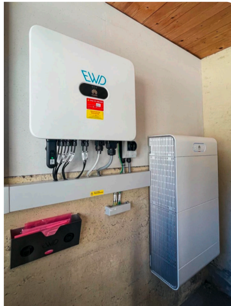
Davos Platz, EWD Solar – PV-Winterstromanlage an Stallfassade mit Batteriespeicher zur Eigenverbrauchsoptimierung
