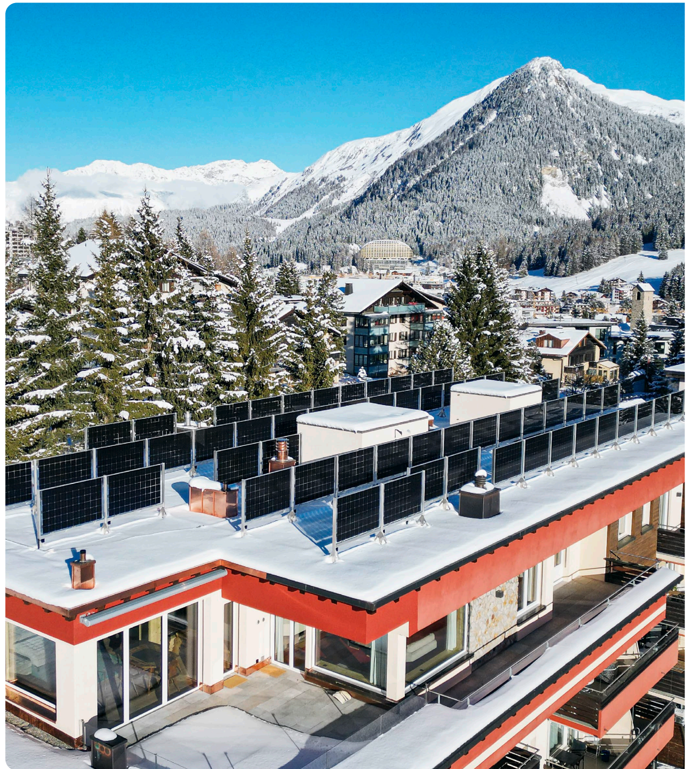
Davos Platz, EWD Solar – PV-Winterstromanlage Geminus.90° auf Flachdach
