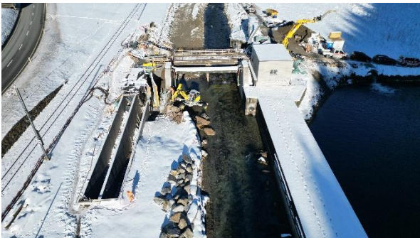
Fischwanderhilfe Wasserfassung Chummen
